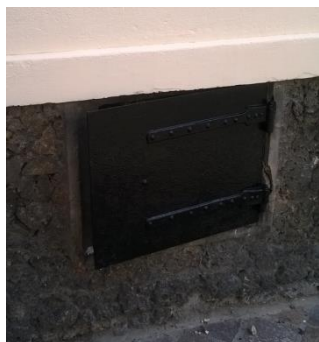
Portes de coffret abritant des compteurs d'énergie
