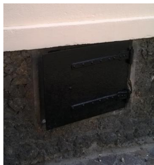
Portes de coffret abritant des compteurs d'énergie
